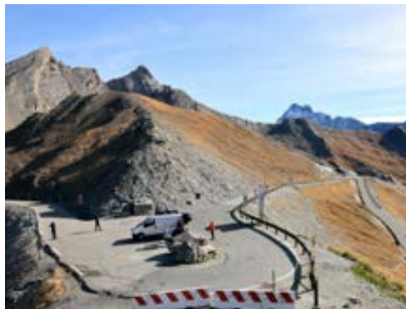
Il Colle dell'Agnello come si presentava prima dei lavori del progetto Grands Cols
